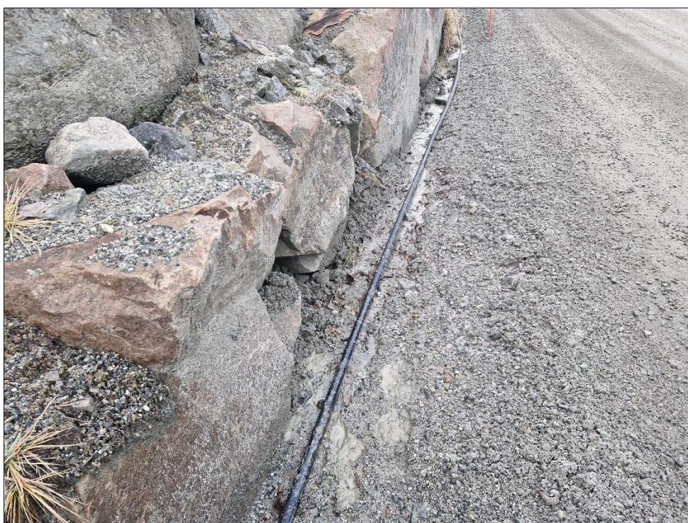
Figur 15. Det kommer ut en god del vann under dagens mur av blokkstein
